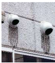
●ドレン排出による外壁の変色
