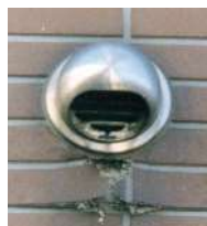
●外壁(サイディング)の凍壊
