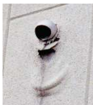
●外壁(モルタル)の凍壊
