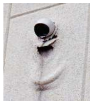
●外壁(モルタル)の凍壊
