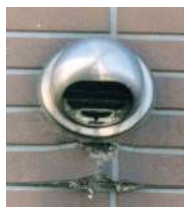
●外壁(サイディング)の凍壊
